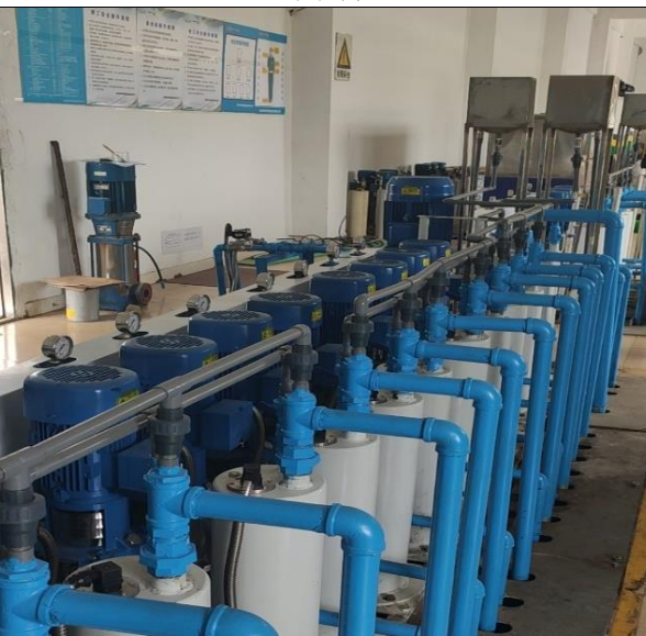
污水循环系统
